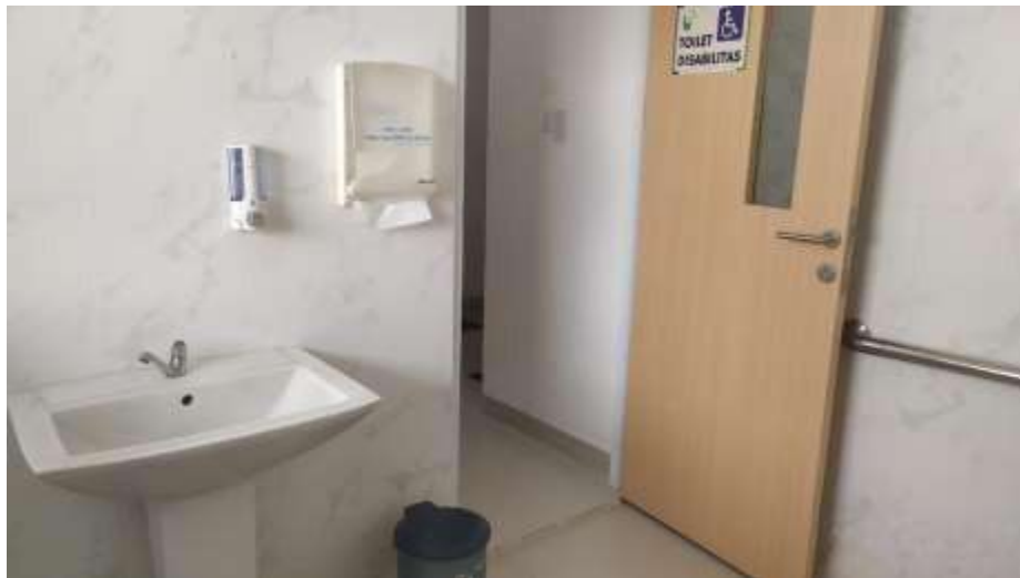
Fasilitas cuci tangan dalam toilet disabilitas
