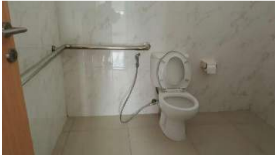
Toilet khusus disabilitas
